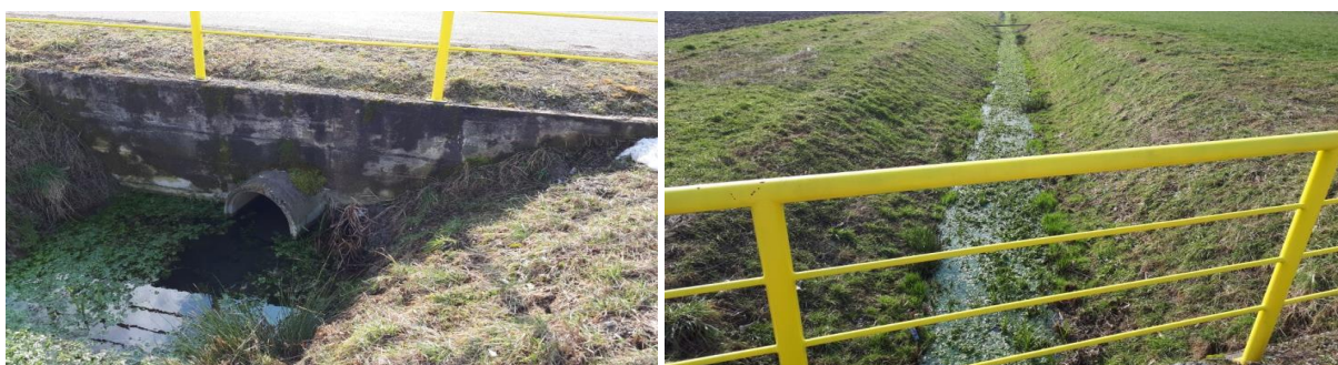
Fotografija 2-5: Cestovni propust i kanal Vukovarski u Vukovarskoj ulici
