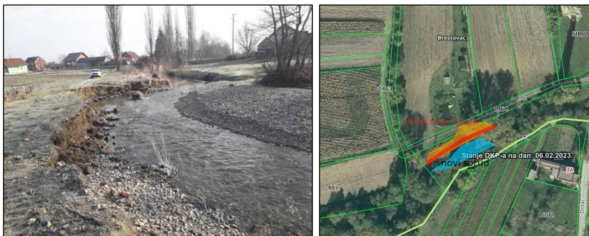
Slika 4. Postojeće stanje lijeve erodirane obale bujičnog potoka Orljavica (Izvor: Idejno rješenje: Hitne intervencije uređenja i zaštite od erozije potoka Orljavica u stac. 2+670 do 2+705 uz k.č.br. 1464 i k.o. Brestovac, Hrvatske vode – VGI za mali sliv "Orljava - Londža", veljača 2023.)
