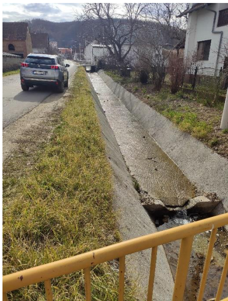
Slika 2.7. Uređeno korito vodotoka u naselju.
