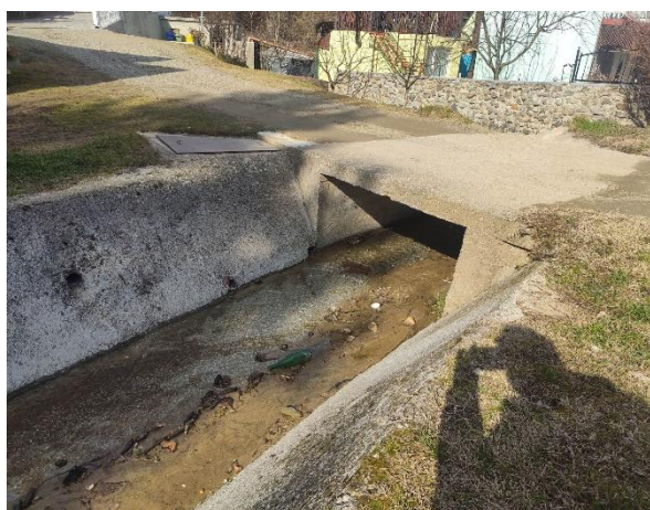
Slika 2.8. Uređeno korito vodotoka u naselju.
