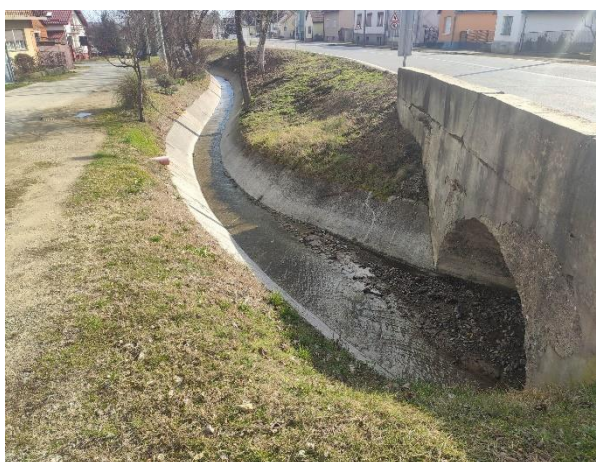
Slika 2.7. Uređeno korito vodotoka u naselju.
